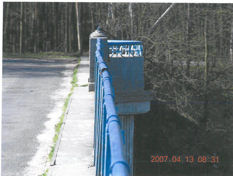
Fot. 15. Widok poręczy jak na fot. 14. Widoczne przemieszczenie pochwyty.
