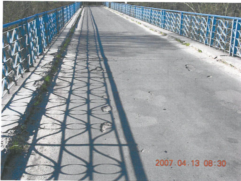
Fot. 7. Widok nawierzchni na moście. Ubytki materiału, spękania i deformacje.
