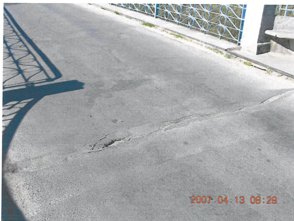
Fot. 10. Widok szczeliny dylatacyjnej na moście. Ubytki i nierówności w nawierzchni przykrywającej szczelinę dylatacyjną.
