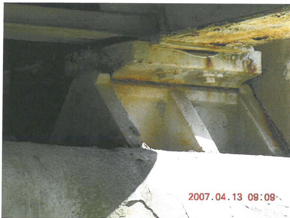
Fot. 33. Korozja powłok ochronnych łożyska stałego.
