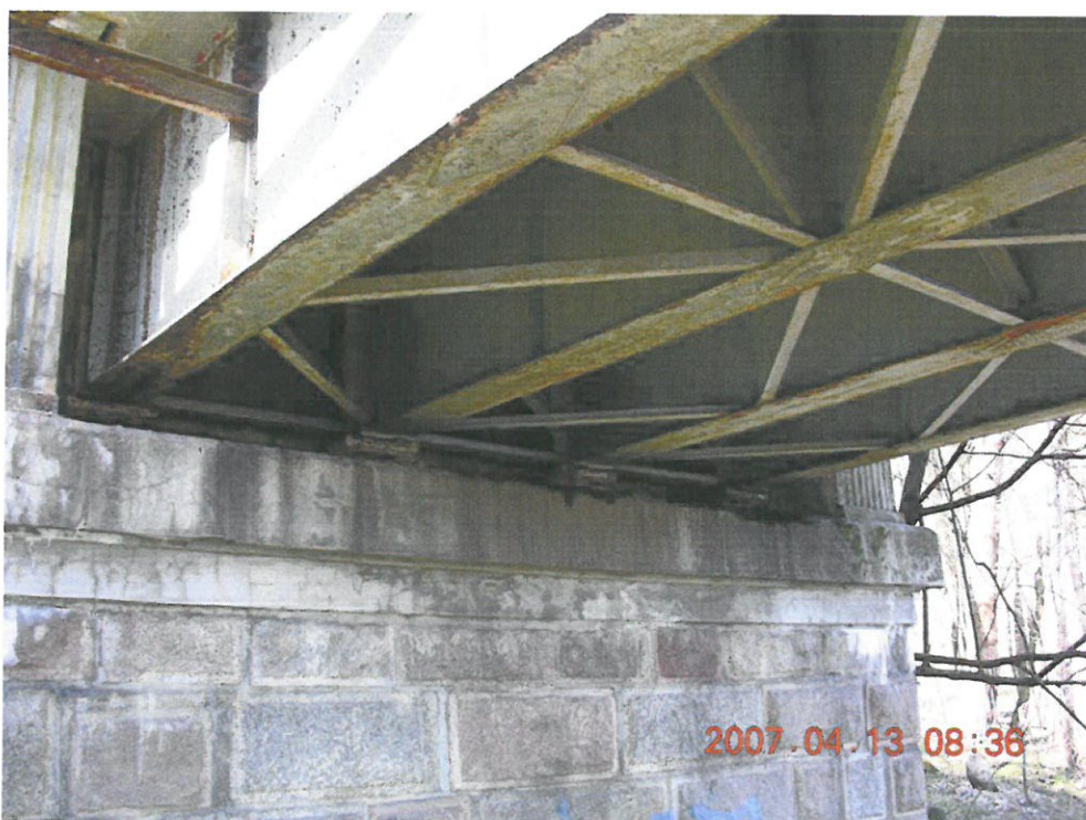
Fot. 18. Widok kamiennego przyczółka od strony Cieblowic. Zarysowania i korozja betonu z naciekami.
