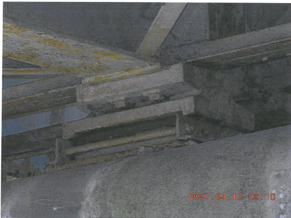
Fot. 35. Łożysko ruchome – korozja powłok malarskich, nacieki na ławie podłożyskowej spowodowane nieszczelnościami szczeliny dylatacyjnej.
