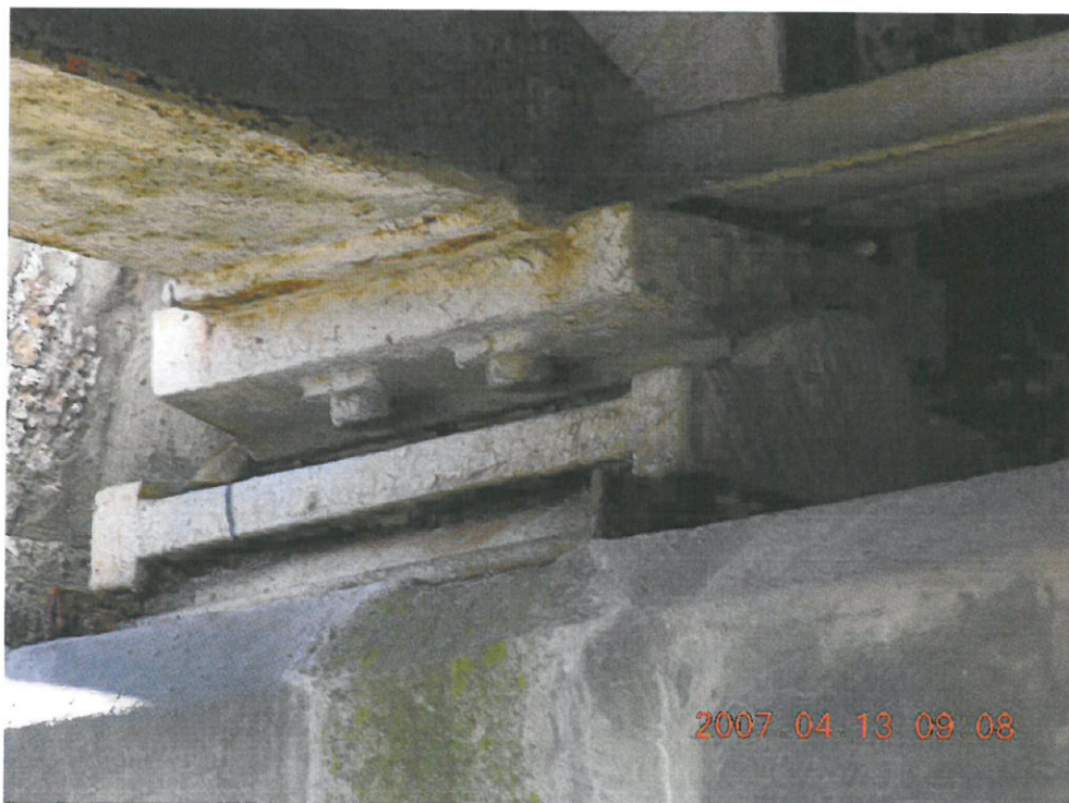
Fot. 32. Łożysko ruchome – korozja powłok ochronnych z naciekami w strefie łąwy podłożyskowej .
