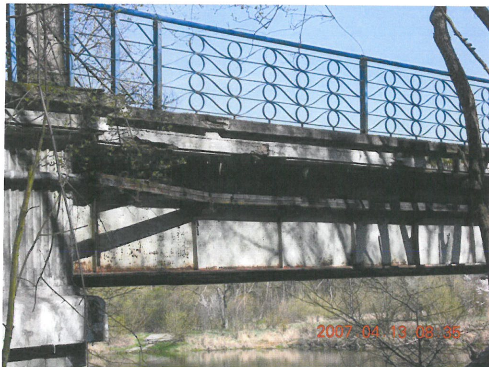
Fot. 19. Widok mostu z boku od strony WD. Podwieszona osłona urządzenia obcego. Korozja betonu belek gzymsowych, korozja osłony kabli i dźwigarów .
