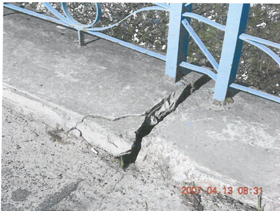
Fot. 11. Widok szczeliny dylatacyjnej w strefie opaski pochodnikowej. Ubytki betonu , brak przykrycia.
