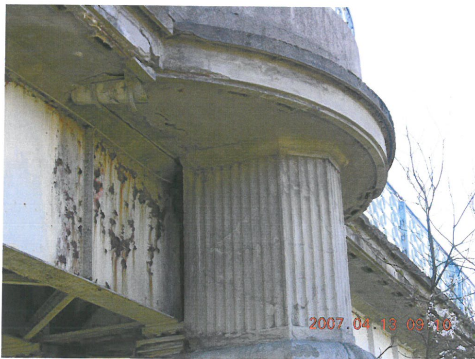
Fot. 28. Widok dźwigarów i opaski chodnikowej przy podporze 3. Stan techniczny jak wyżej.
