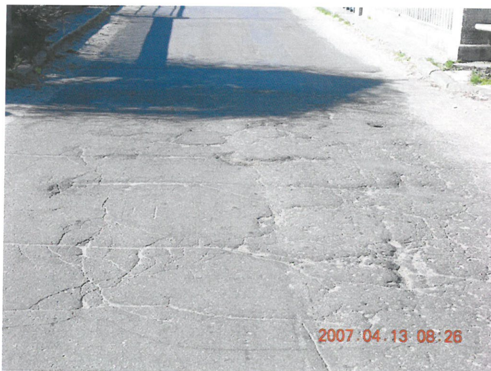
Fot. 5. Nierówności i znaczne spękania nawierzchni na dojeździe do mostu od strony Spały.
