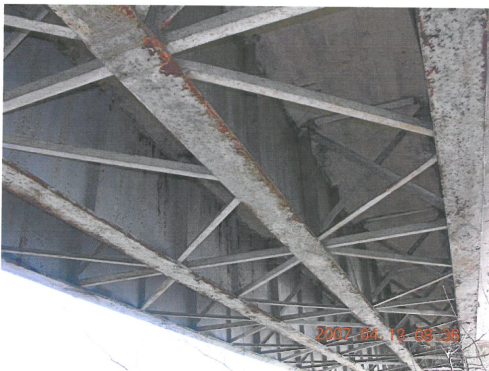
Fot. 22. Widok spodu mostu. Korozja pokryć malarskich stalowych dźwigarów.
