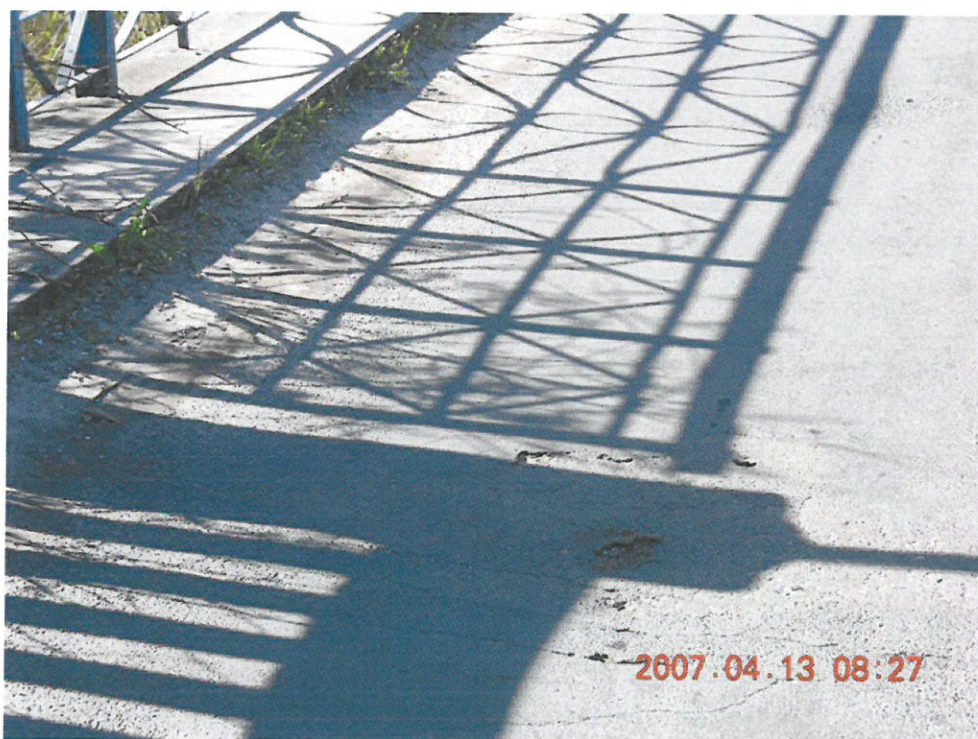
Fot. 12. Widok jezdni i opaski chodnikowej. Zanieczyszczenia gruntem, wegetacja roślin, Pęknięcia i nierówności w nawierzchni jezdni.
