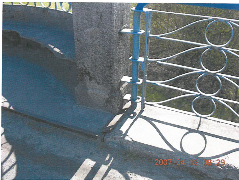
Fot. 16. Widok opaski chodnikowej z przemieszczonym przykryciem szczeliny dylatacyjnej.
