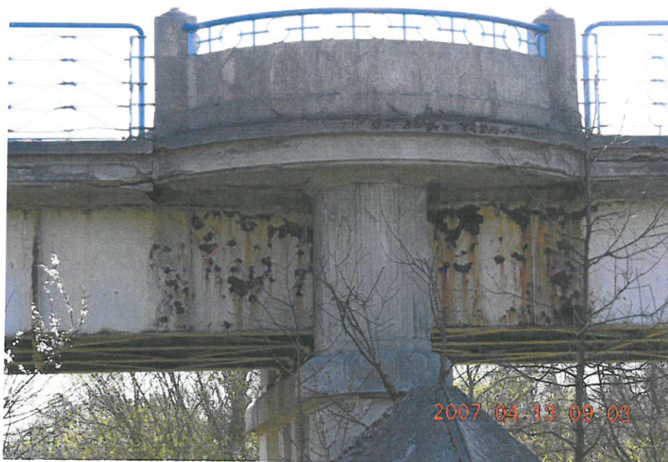
Fot. 27. Widok w strefie podpory nr.4. Silna korozja dźwigarów, korozja i spękania betonu w strefie belki gzymsowej.
