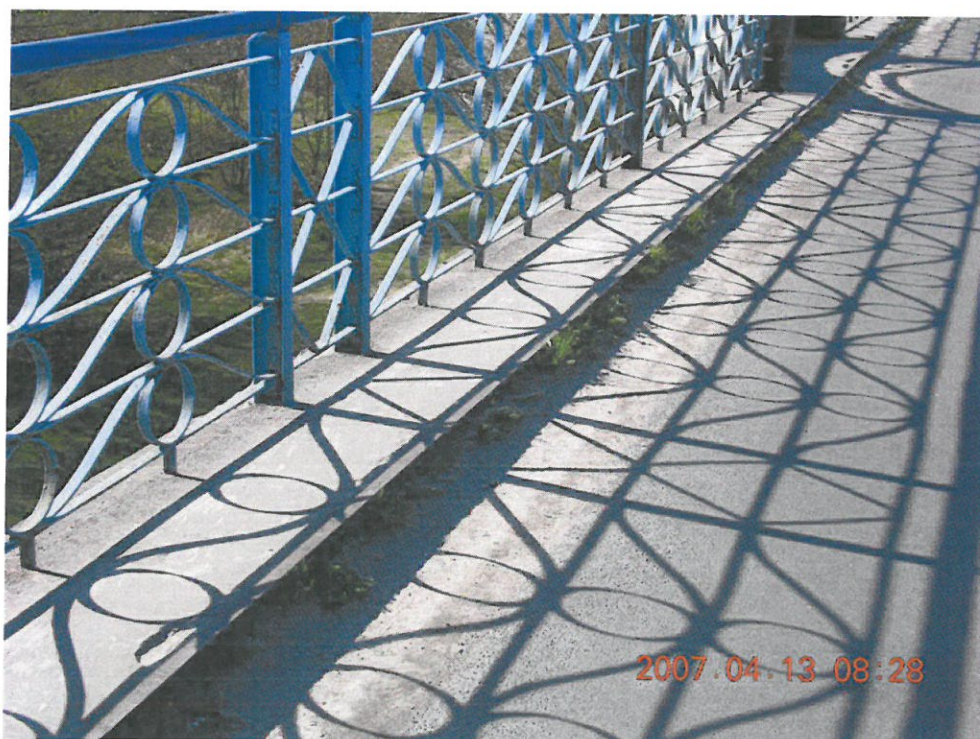
Fot. 6. Widok jezdni i opaski chodnikowej na moście. Zanieczyszczenia gruntem , wegetacja roślin .
