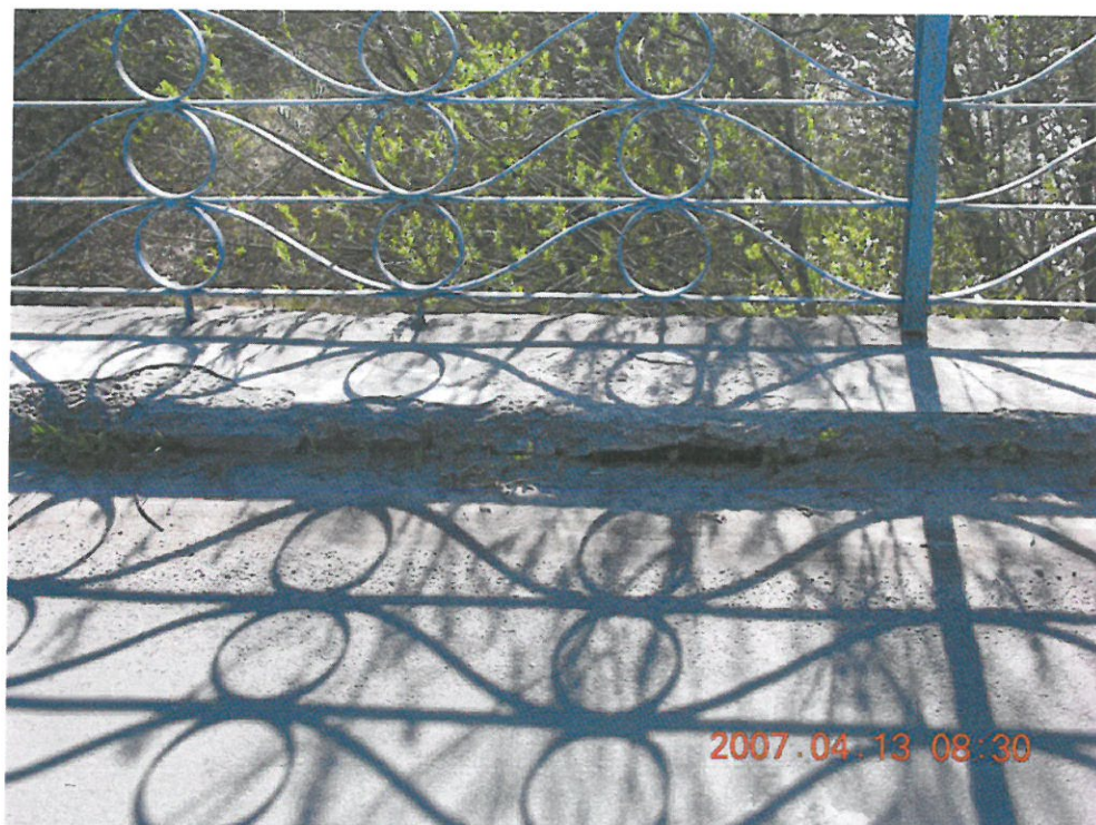
Fot. 9. Widok opaski chodnikowej ze zniszczonymi odprowadzeniami wody opadowej z jezdni.
