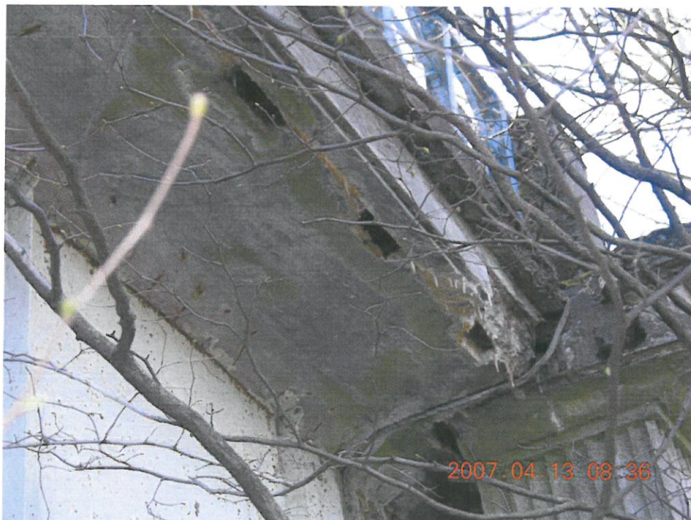
Fot. 24. Widok urządzeń do odprowadzenia wody z mostu. Ubytki betonu, wykwit, stalaktyty, nacieki, wylugowania. Widok od strony WD.
