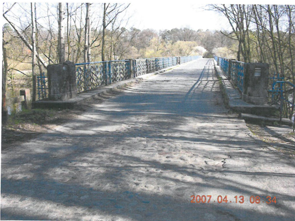
Fot. 4. Widok mostu w planie drogi od strony Cieślówic. Stan techniczny nawierzchni na dojeździe do mostu- zniszczona nawierzchnia asfaltowa z odkrytą warstwą nawierzchni z kamienia brukowego.
