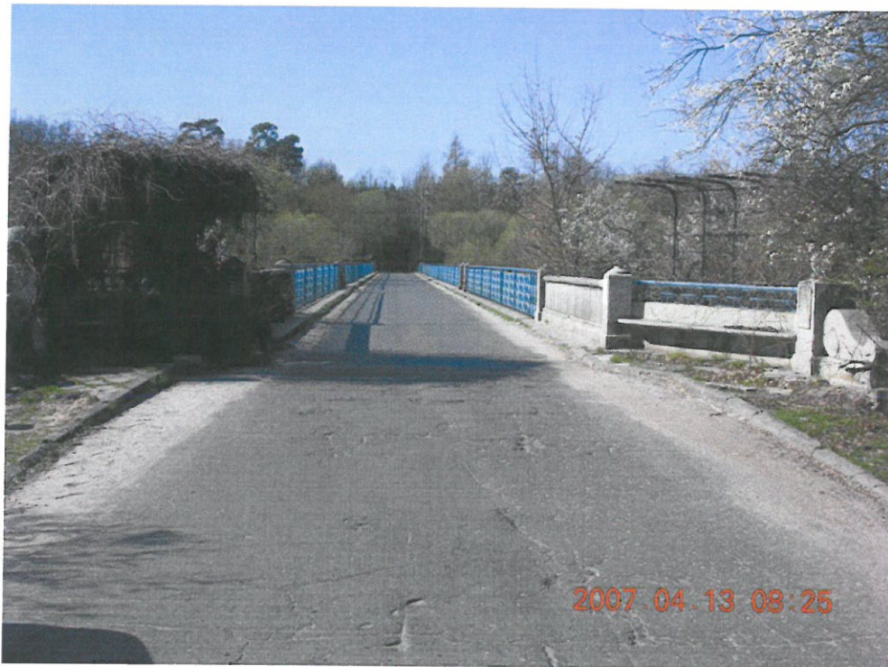
Fot. 3. Widok mostu w planie drogi. Spękania i nierówności nawierzchni na dojeździe od strony Spały.
