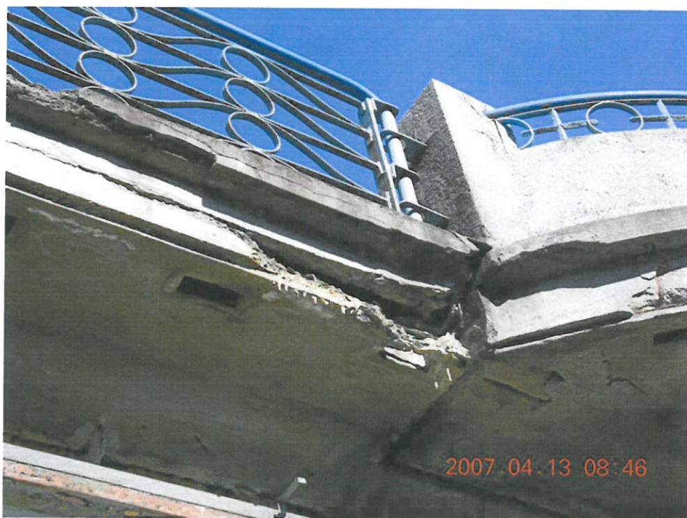
Fot. 26. Widok od strony WD. Korozja z ubytkami betonu w strefie dylatacji.
