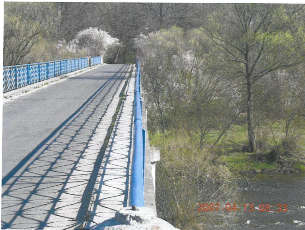
Fot. 13. Zdeformowane poręczce ochronne.
