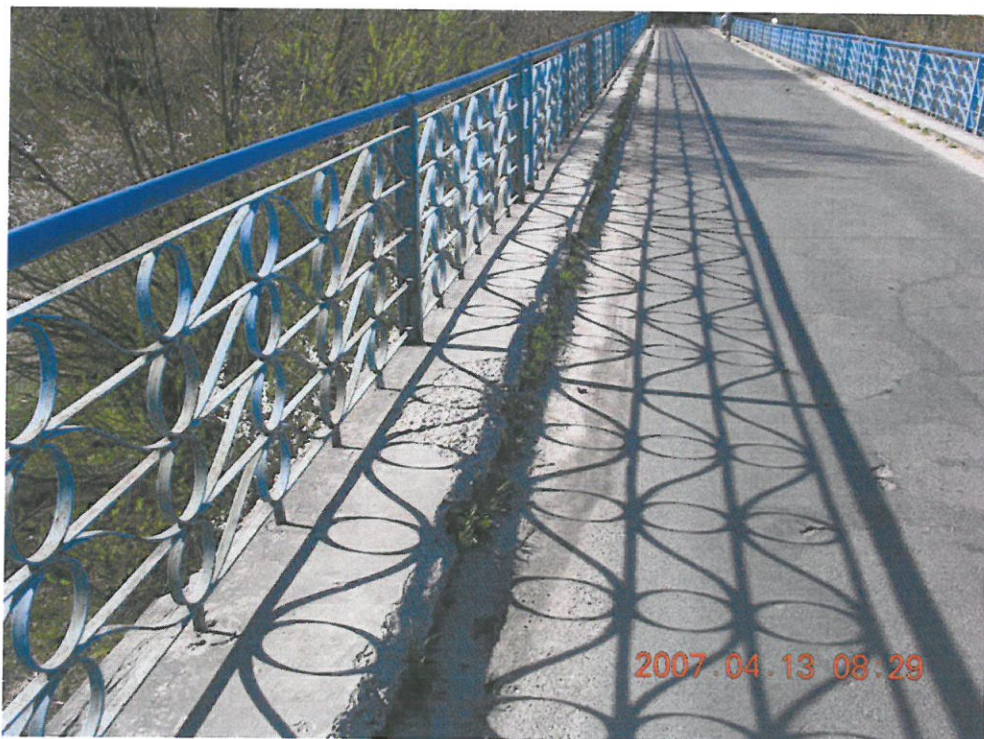
Fot. 8. Stan techniczny opaski chodnikowej od strony WD. Ubytki betonu i kątownika ochronnego.
