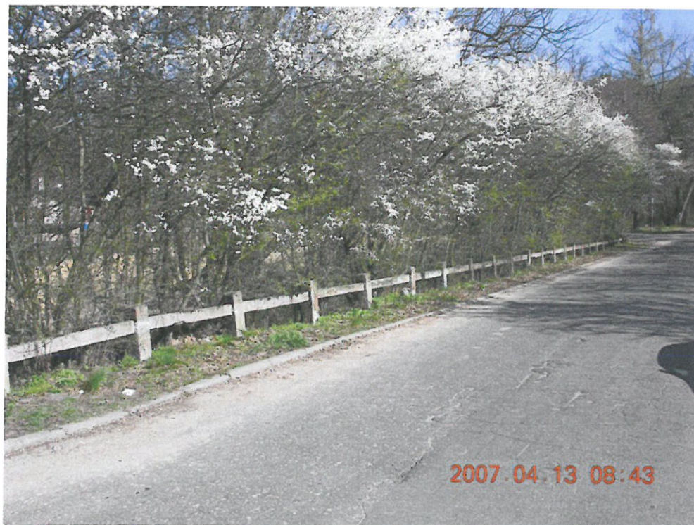
Fot. 41. Betonowe bariery ochronne na dojeździe do mostu – widok od strony Spały.
