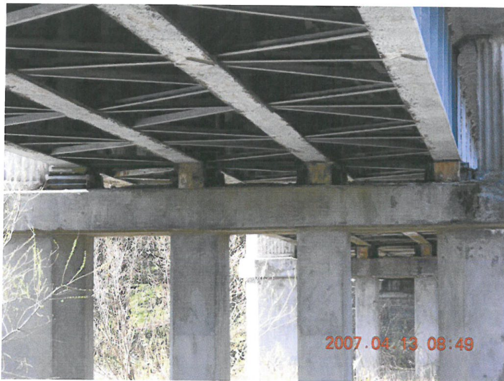
Fot. 21. Widok podpory nr. 3. Podparcia dźwigarów . Korozja betonu w strefie podłożyskowej.
