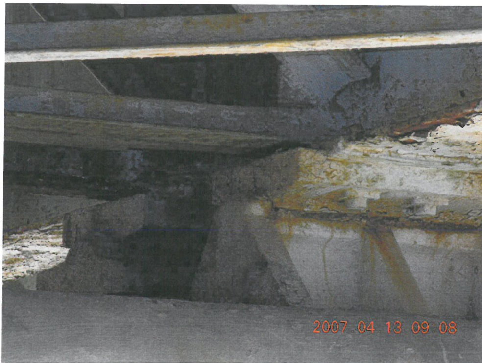
Fot. 31. Łożysko ruchome i stałe – korozja powłok ochronnych z korozją stali.
