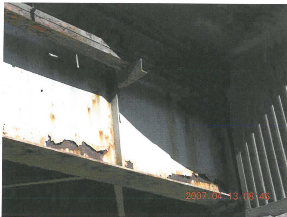
Fot. 29. Widok skrajnych stalowych dźwigarów . Korozja powłok malarskich.
