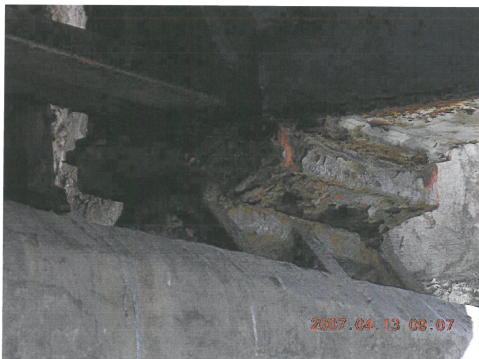
Fot. 34. Łożysko stałe – silna korozja powłok i materiału łożyska z korozją stalowego dźwigara .
