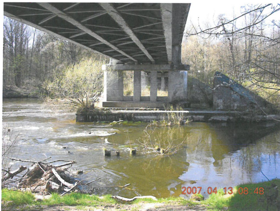
Fot. 39. Widok koryta rzeki- zanieczyszczenia, pozostałości drewnianych podpór.
