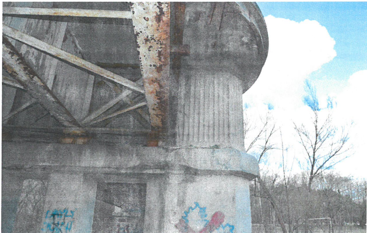
Uszkodzenia betonu filara w strefie podłożyskowej – pierwszy filar lewobrzeżny.
