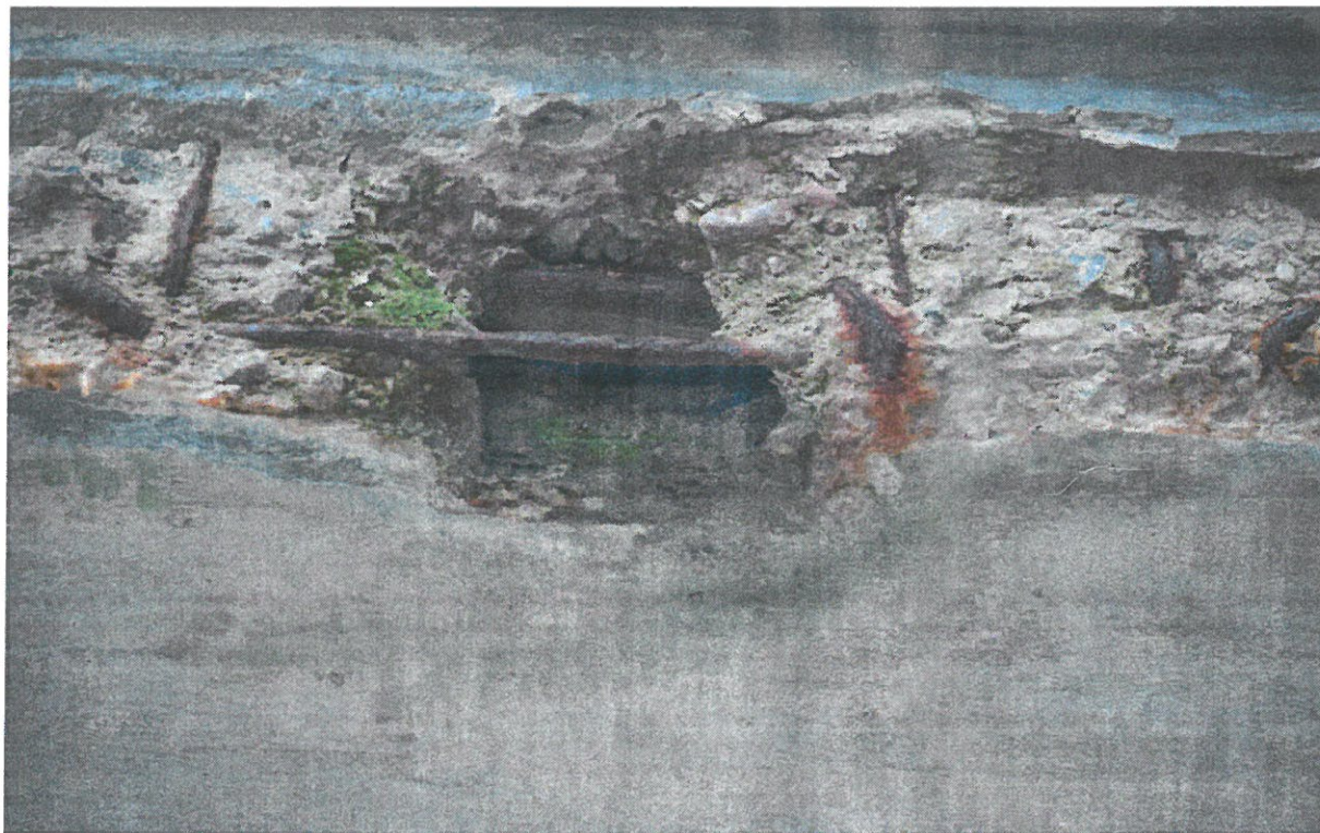
Powszechnie występująca degeneracja krawędzi płyty wspornika wskutek złego odwodnienia obiektu.
