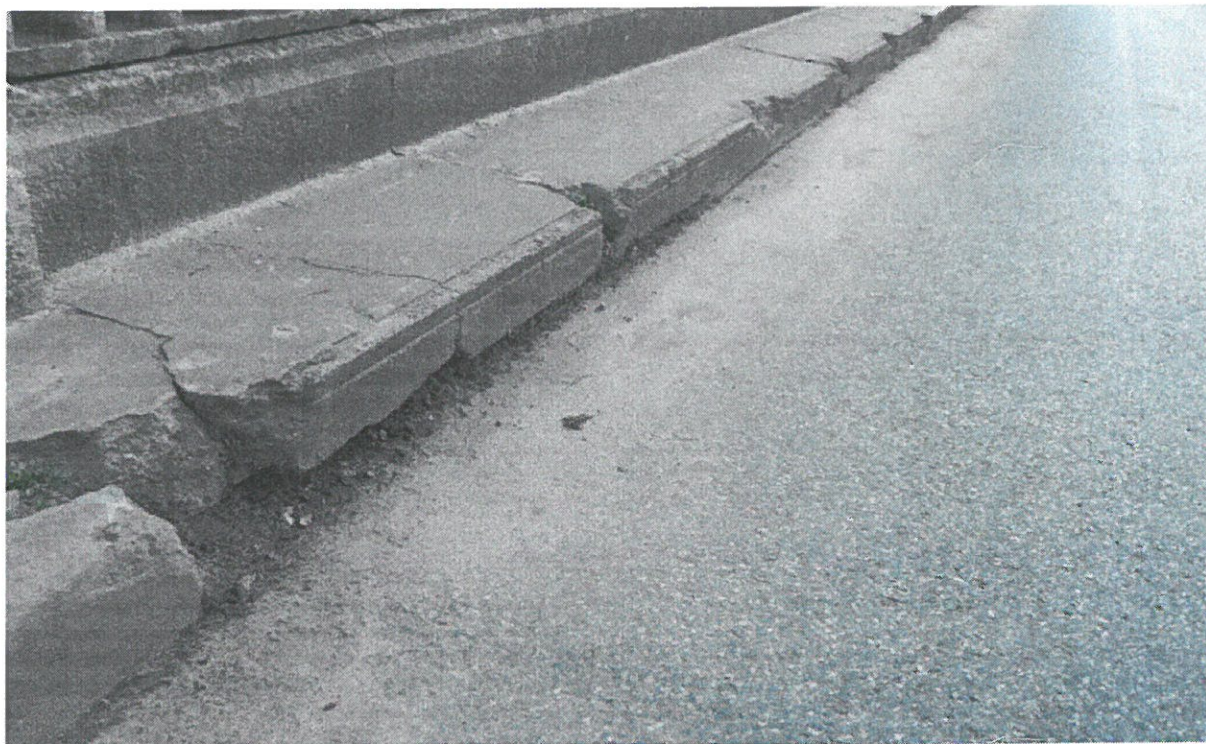
Spękana konstrukcja opaski betonowej, chodnikowej, brak kątownika ochronnego
