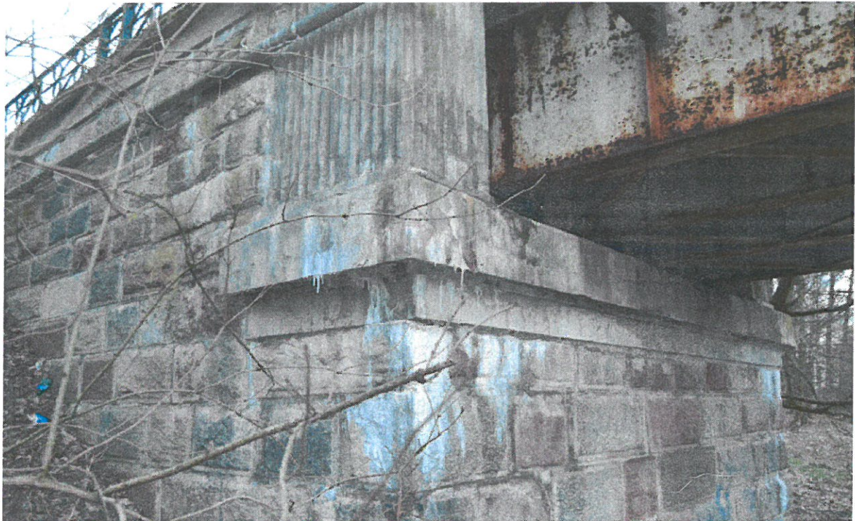
Brak odwodnienia prawobrzeżnego przyczółka
