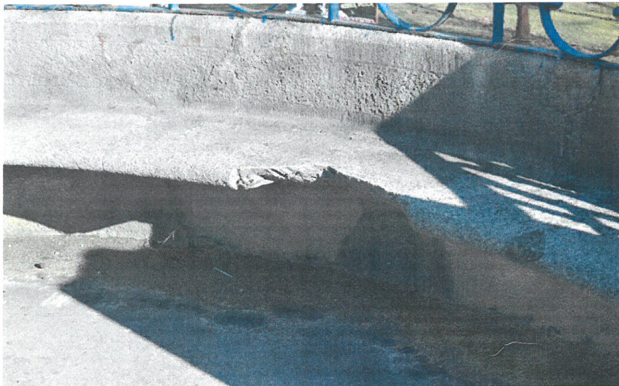
Ubytki siedziska, spękania balustrady betonowej.
