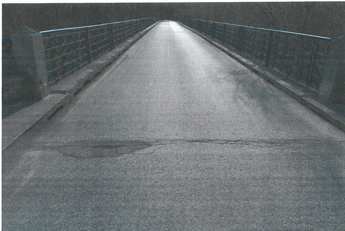
nawierzchnia na dylatacji nad filarem nr 1 na prawym brzegu – zaniżenie i spękanie nawierzchni powodujące przecieki wody opadowej.
