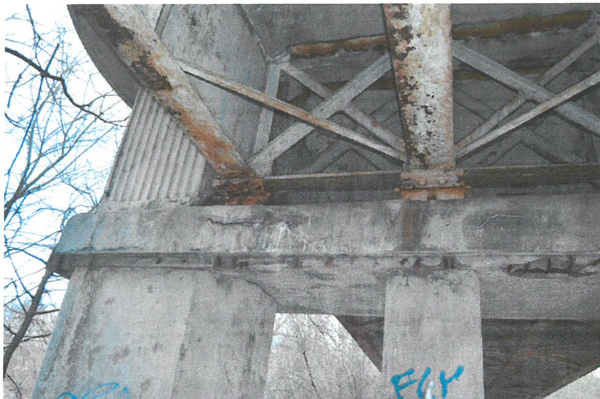
Uszkodzenia betonu filara w strefie podłożyskowej – pierwszy filar lewobrzeżny.
