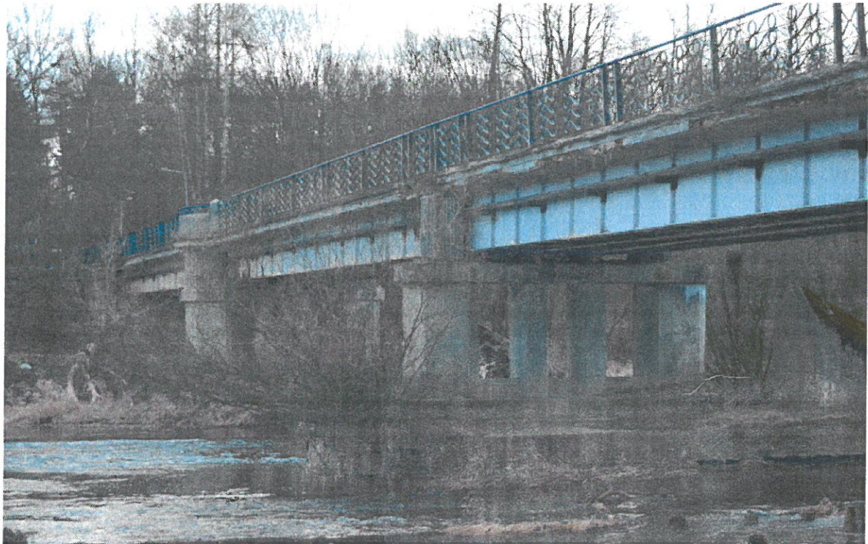
Zarastające roślinnością, zanieczyszczone, zawilgocone filary.
