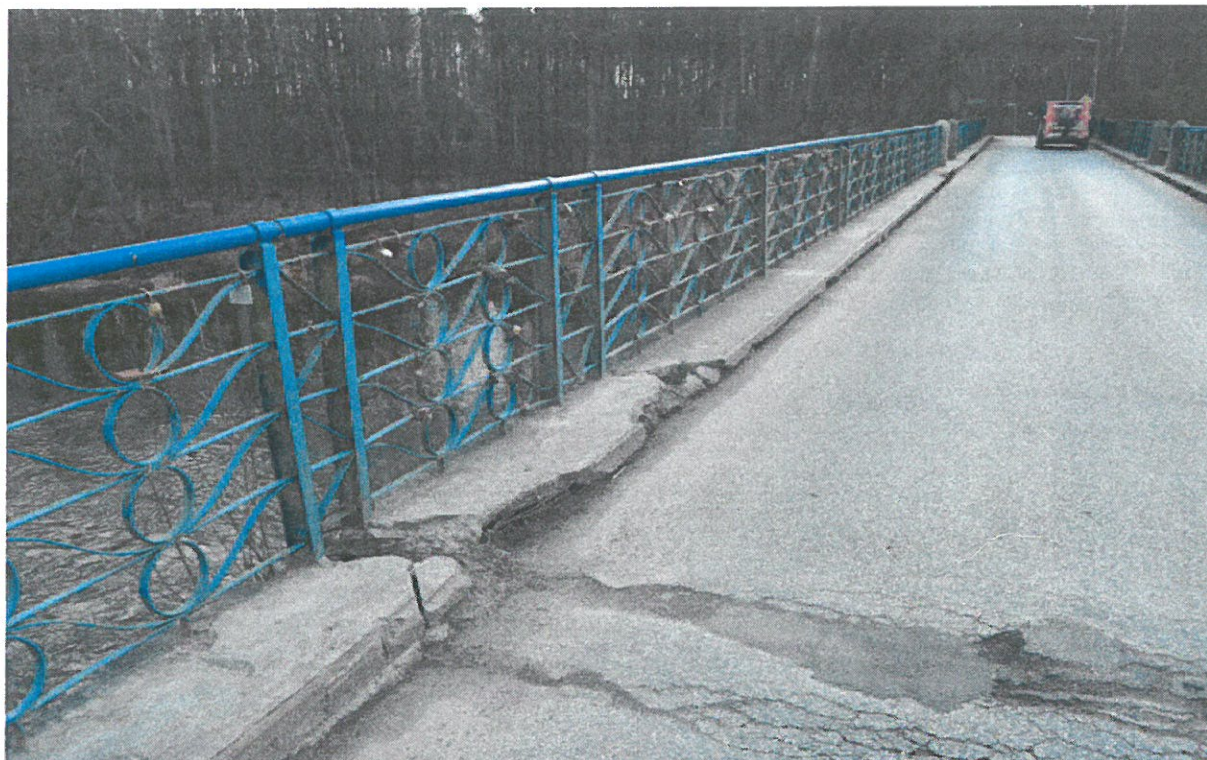
Uszkodzenie opaski nad niesprawną dylatacją obiektu.
