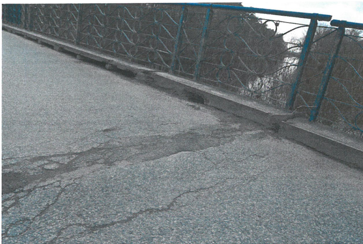
Spękania nawierzchni nad kolejną dylatacją.
