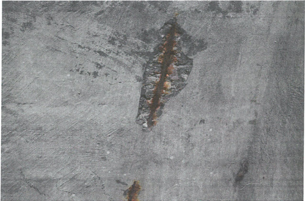
Zbliżenie widoku wyluszczeń płyty pomostu.
