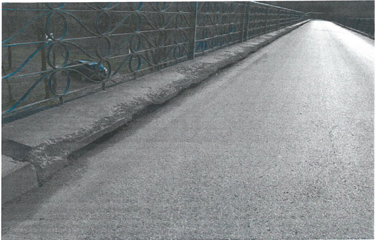
Znaczne wykruszenia betonu opaski betonowe.
