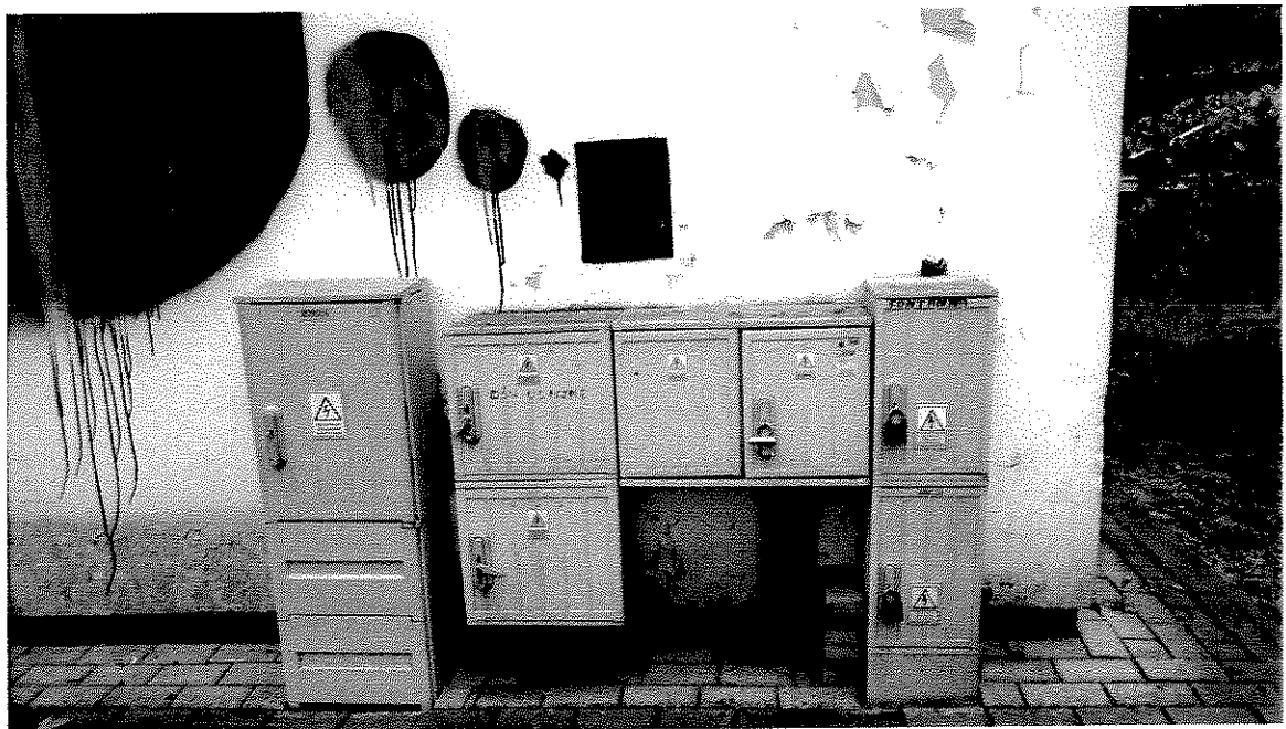
Przykład wyniesienia szafki ze stacji transformatorowej ( lok. Spała)
