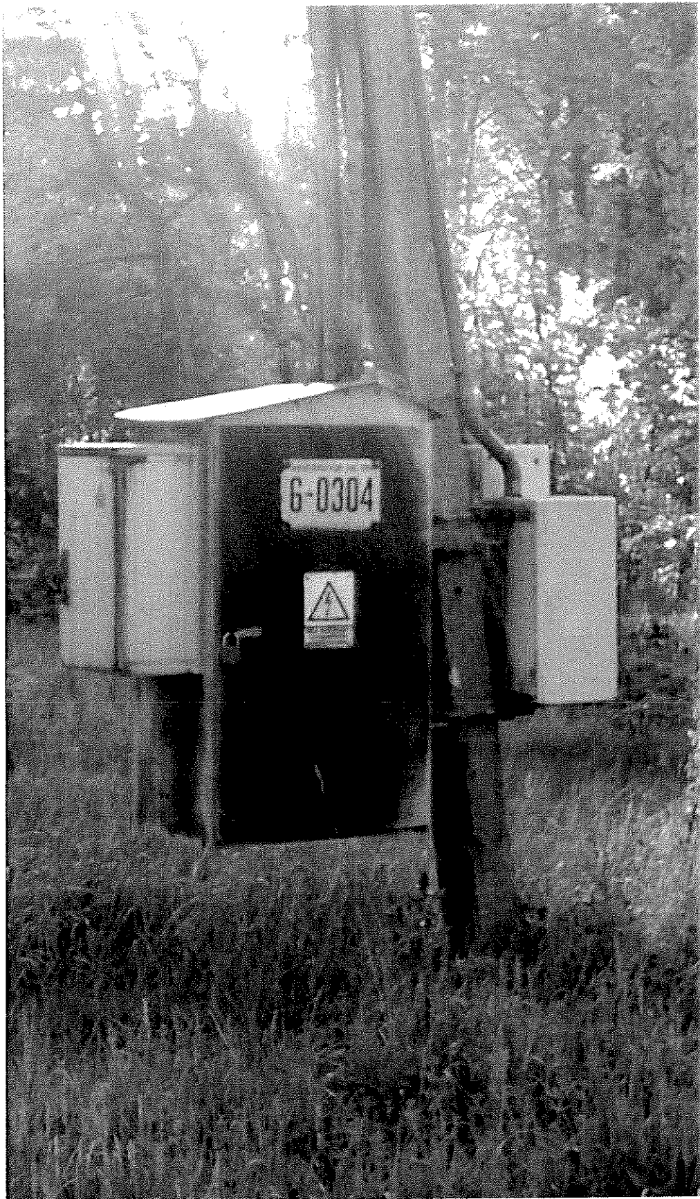
Przykład wyniesienia szafki ze stacji transformatorowej (lok. Teofilów)
