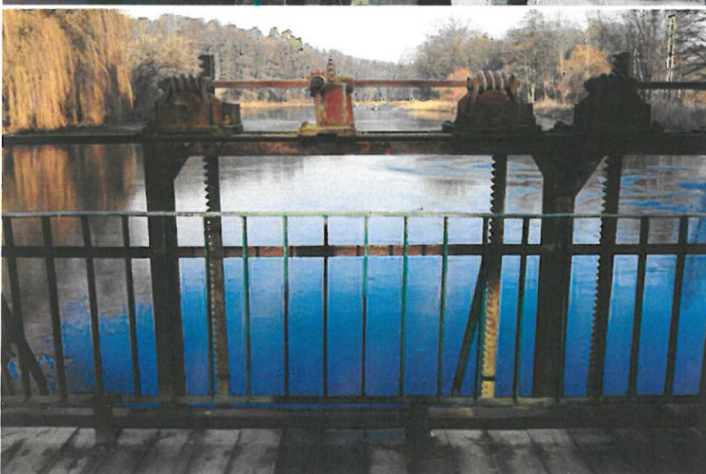
Fot. 6 Ślimacznice urządzenia podnoszącego. Uszkodzone, popękane.
