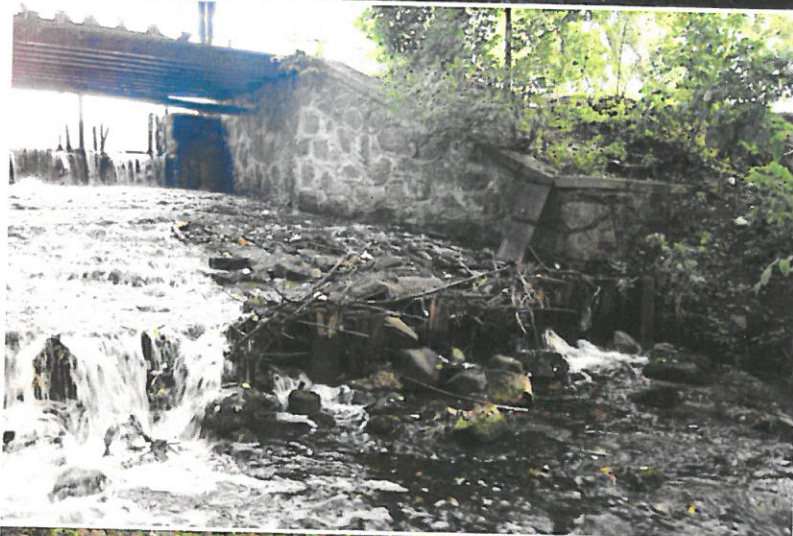
Fot. 8 Zniszczony wylot płyty dennej, zniszczona drewniana ścianka szczelna, brak umocnień dna rzeki poniżej wylotu.
