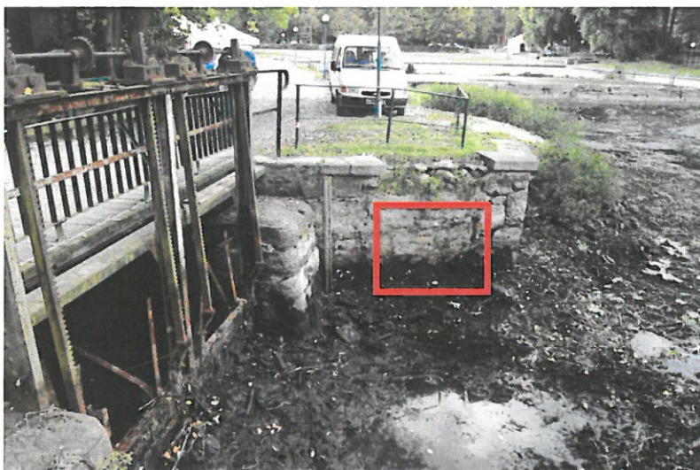
Fot. 4 Wlot jazu ze zniszczonymi zasuwami i niesprawnym mechanizmem podnoszącym. Oznaczony zabetonowany wlot do turbiny.
