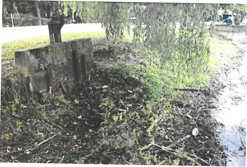
Fot. 16 Zniszczony wlot rurociągu napętniającego staw parkowy.
