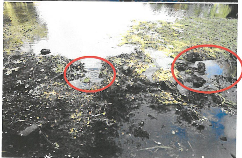
Fot. 3 Dno wlotu jazu z zaznaczonymi miejscami ucieczki wody pod płytę denną.
