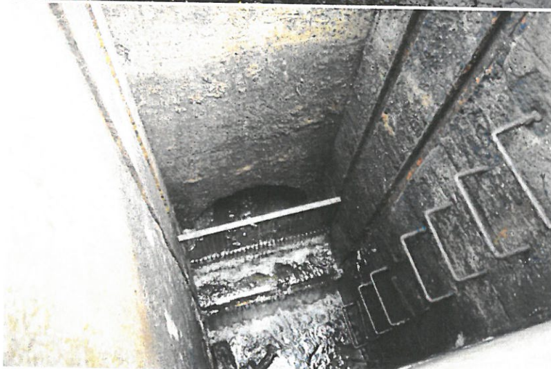
Fot. 12 Studnia śluzu, widoczne zdegradowane prowadnice i stopnie złączowe. Korozja betonu ścian studni.
