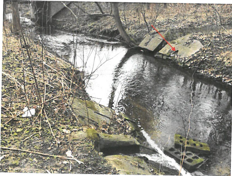
Fot. 17 Widoczne zniszczenia umocnień wylotów do rzeki. Oznaczony wylot rurociągu odwadniającego basen.
