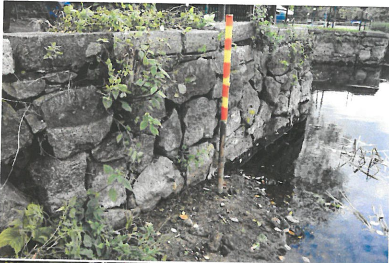
Fot. 10 skrzydła jazu. Widoczne uszkodzenia, braki spoin i wrastająca w nie roślinność.
