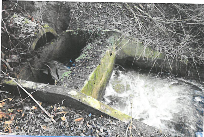
Fot. 13 Zniszczony wylot ze śluzy.
