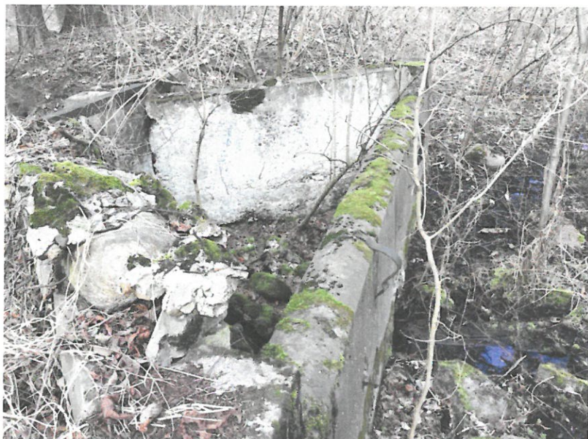
Fot.7 Budowla piętrząco – upustowa na stawie parkowym. Stopień zniszczenia nie kwalifikuje budowli do remontu, a jedynie do rozbiórki.
