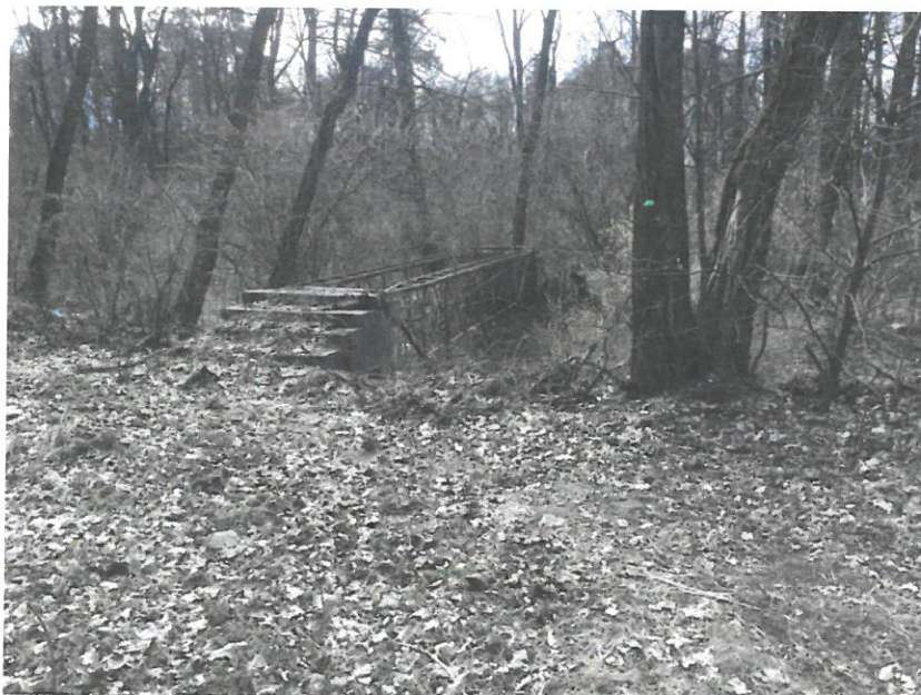
Fot.6 Widok stawu parkowego od strony grobli czołowej zbiornika, widoczny most prowadzący na wyspę (w ruinie).
