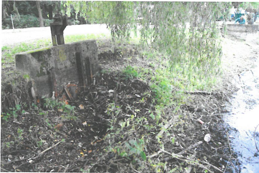
Fot.4 Pozostałości zasuw otwierającej dopływ do stawu parkowego.
