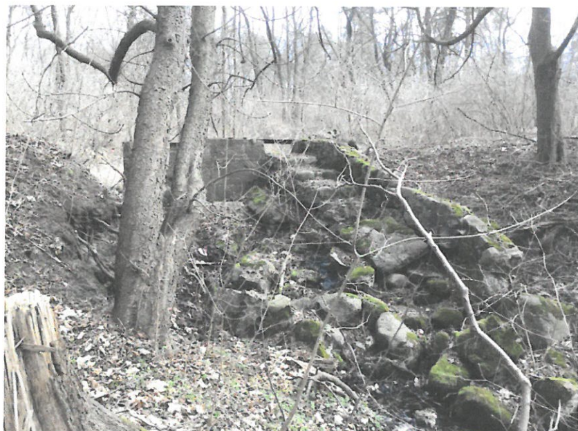
Fot.8 Pozostałości kaskady na wylocie wód z urządzenia piętrząco upustowego na stawie parkowym. Budowla do rozbiórki.
