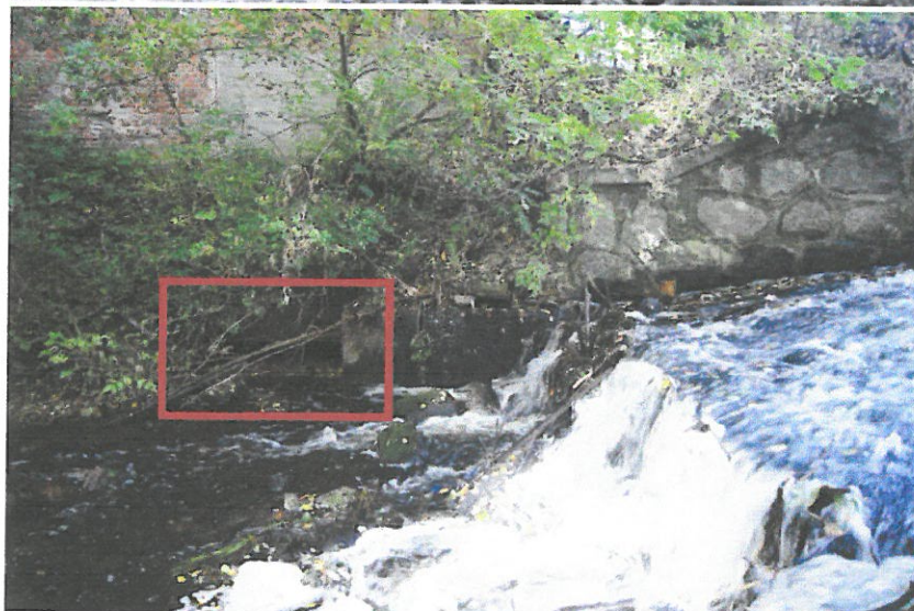
Fot. 9 Widoczny brak umocnień wylotu płyty dennej. Oznaczony wylot rurociągu turbiny.
