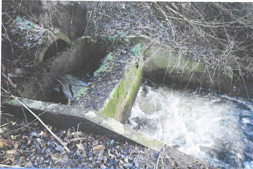
Fot. 13 Zniszczony wylot ze śluzy.
