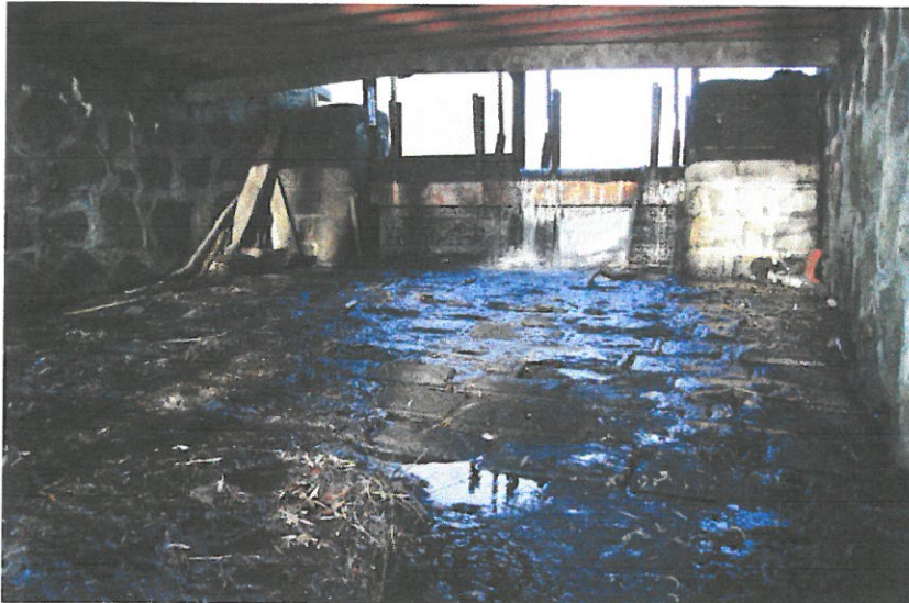
Fot. 7 Zniszczone zasuwki i płyta dolna jazu. Kamienne ściany jazu w stanie dobrym, widoczne ślady poprawek murarskich.
