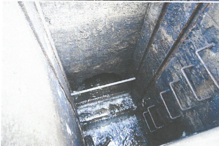
Fot. 12 Studnia śluzy, widoczne zdegradowane prowadnice i stopnie złączowe. Korozja betonu ścian studni.
