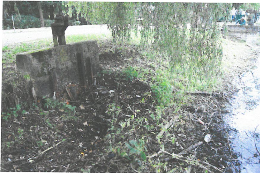
Fot. 16 Zniszczony wlot rurociągu napęniającego staw parkowy.
