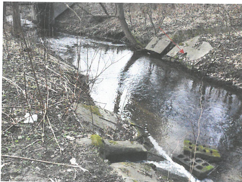
Fot. 17 Widoczne zniszczenia umocnień wylotów do rzeki. Oznaczony wylot rurociągu odwadniającego basen.
