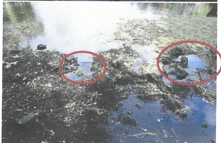
Fot. 3 Dno wlotu jazu z zaznaczonymi miejscami ucieczki wody pod płytę denną.
