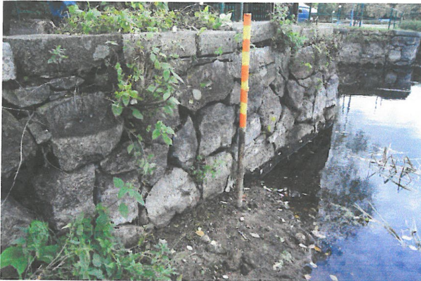
Fot. 10 skrzydła jazu. Widoczne uszkodzenia, braki spoin i wrastająca w nie roślinność.
