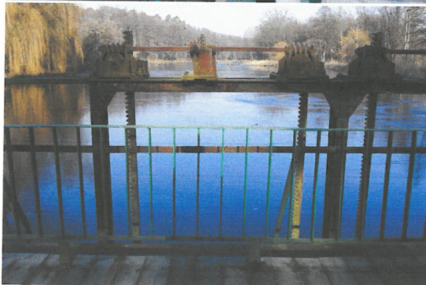
Fot. 6 Ślimacznice urządzenia podnoszącego. Uszkodzone, popękane.
